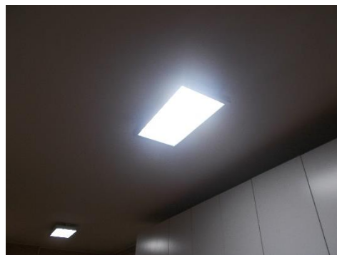
Figura 4.11 - Particolare dei corpi illuminanti
