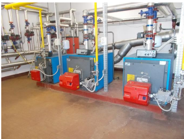
Figura 4.8 - Particolare dei generatori
