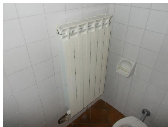
Figura 4.7 - Particolare dei radiatori
