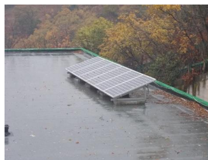
Figura 4.12 - Vista dell'impianto fotovoltaico
